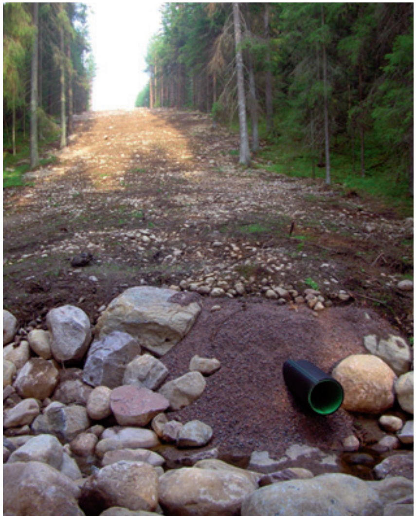
Kuva 5. Hulevesijärjestelmän purku jouduttiin rakentamaan jyrkän rinteän alapuolelle (Kuva: Anniina Pouta).
