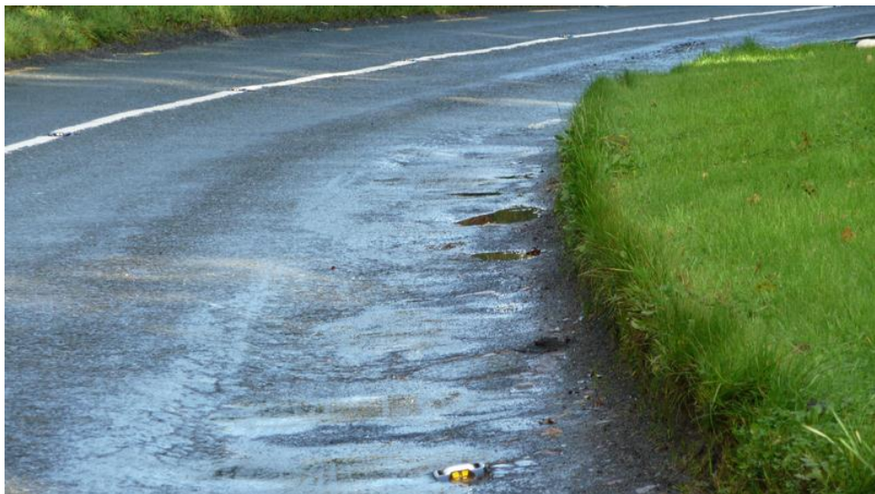
Kuva 4. Korkea reunapalle (Kuva: http://www.roadex.org/index.php/drainage7fi ).
